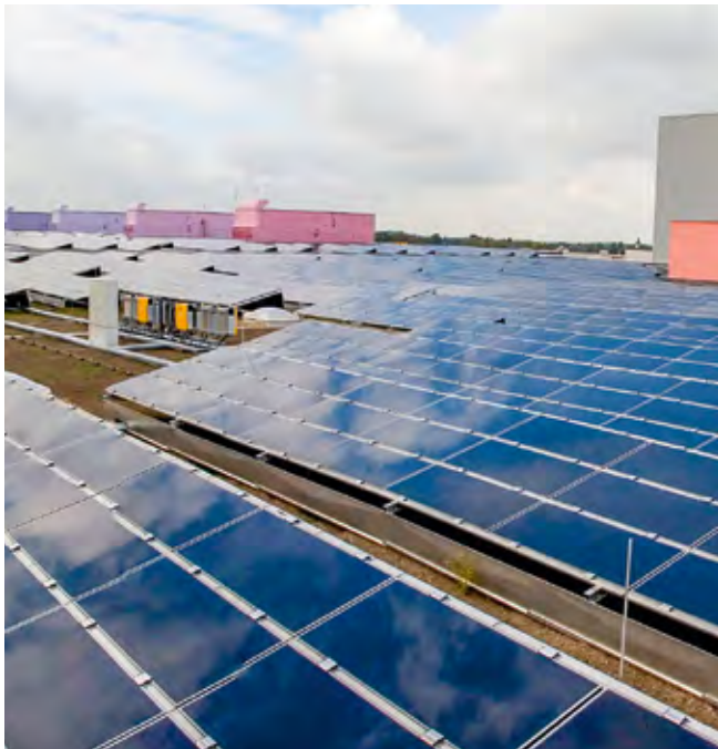
Die Fotovoltaikanlage auf dem Dach unseres Verteilzentrums Weilerswist.
